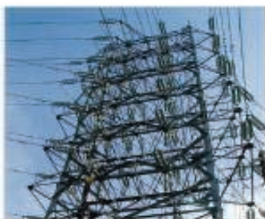
สถานีไฟฟ้า
