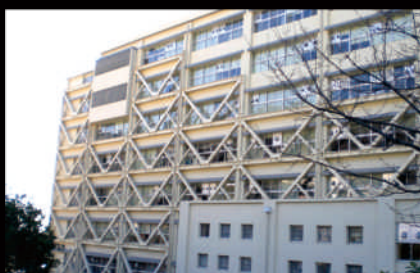
日本 神戶大學防震補強柱
