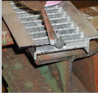
切断面、溶接部
